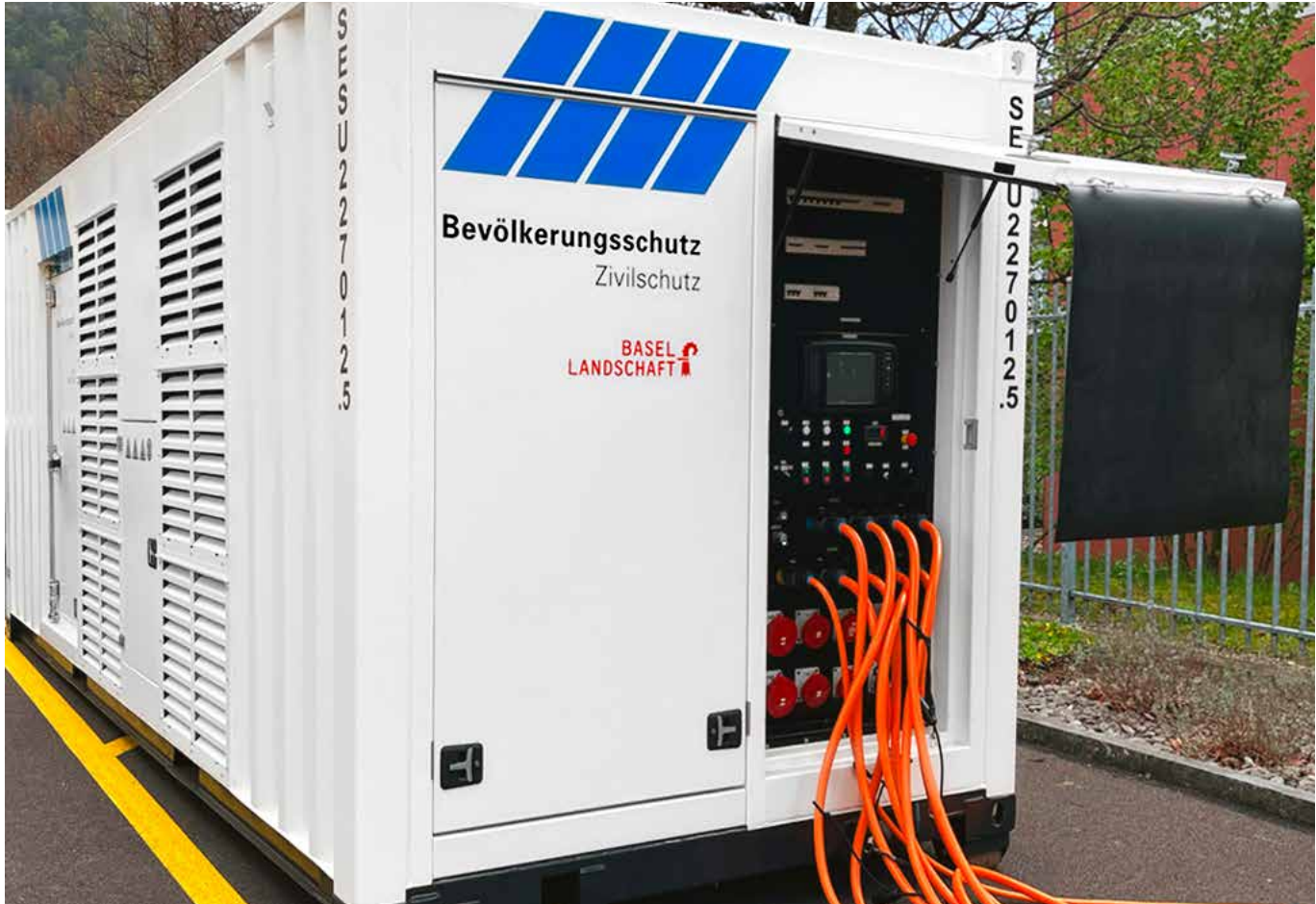
Betriebsbereites Aggregat. Gut sichtbar die orangen Hochstromkabel, welche den Strom in die Hauptverteilung der Kaserne leiten.
